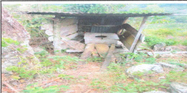
Foto 3: En esta imagen se puede apreciar el baño que esta en servicio de los alumnos y docente. Es un baño compartido, por lo que la estructura esta muy deteriorada, y eso representa mucho riesgo para la vida de los niños.
