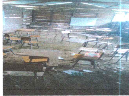
Foto 2: En esta imagen se observa que esta en malas condiciones el aula
